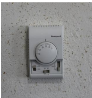
شکل ۵- استفاده از ترموستات ها
